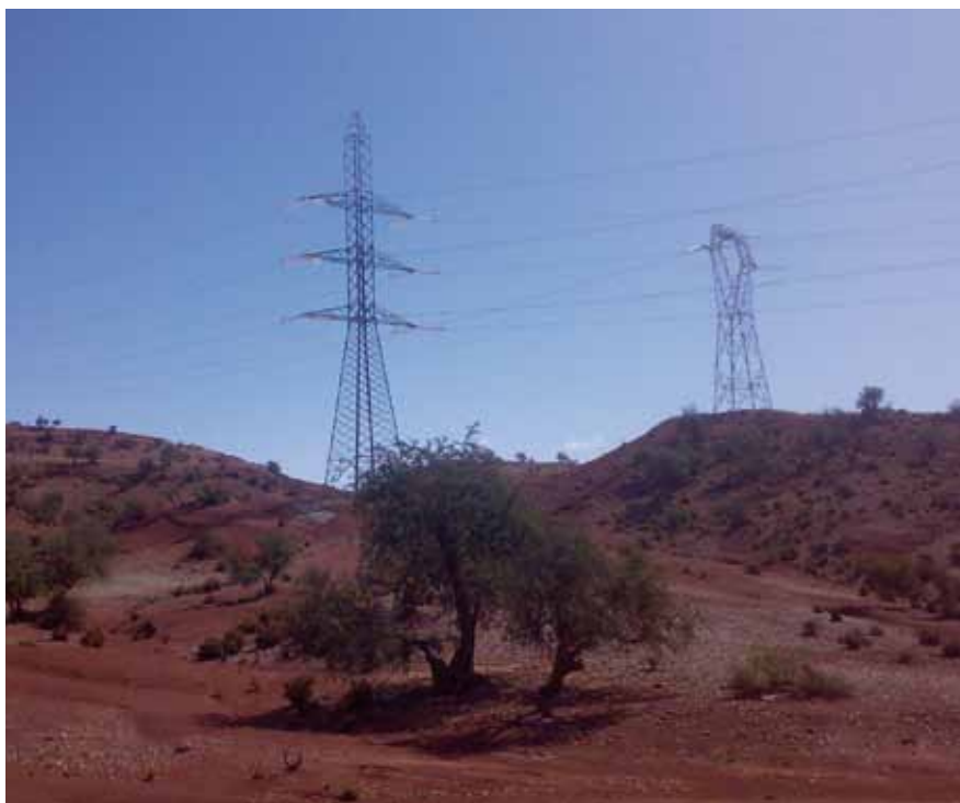
Líneas de transmisión Chichaoua-Agadir (Abengoa)
