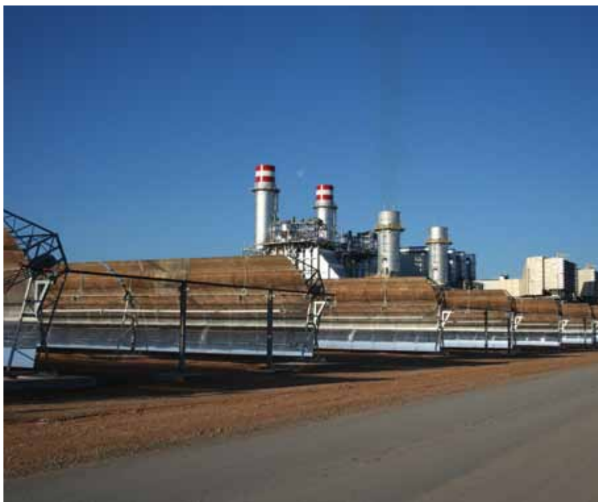
Central de ciclo combinado Ain Beni Mathar (Abengoa)
